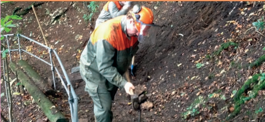
Die RZSO Untere Hauenstein bei ihrem letzten WK: Die Zivilschützer stellen den Weg, welcher zum Naturfreundehaus auf der Rumpelweide führt, instand.
