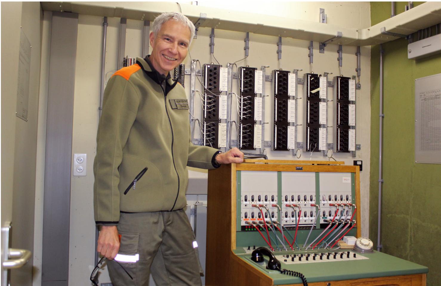
Hansruedi Affolter steht vor der alten Telefonzentrale, die mittlerweile seit rund zehn Jahren ausser Betrieb ist.
